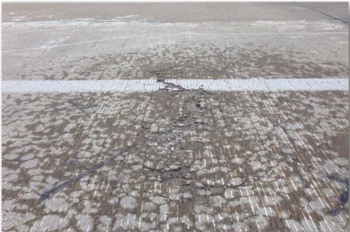
Рисунок 4 – Сетка трещин с выкрашивание цементного камня и заполнителя.
