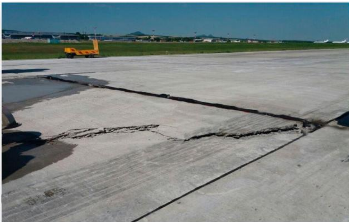
Рисунок 3 – Скол части плиты в результате температурного перенапряжения
